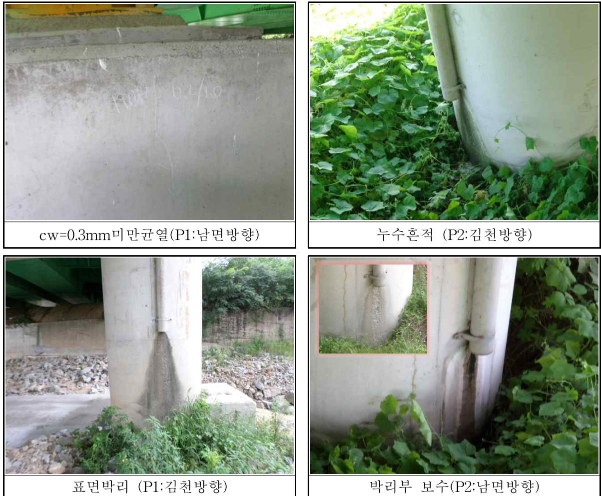
【그림 3.20】 교각 손상 현황
