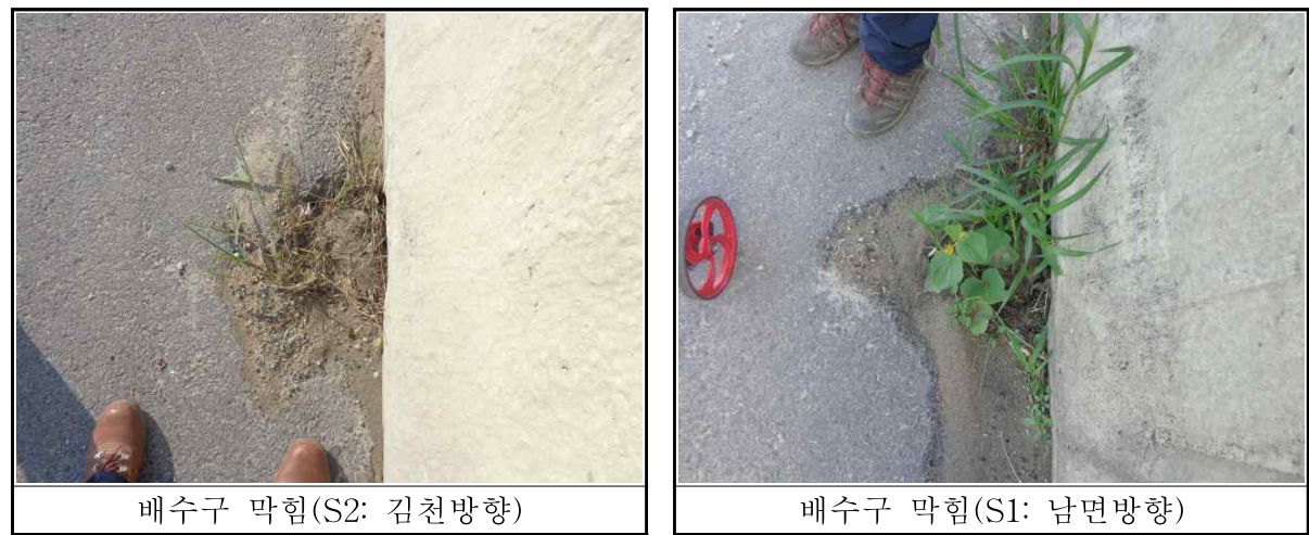
【그림 3.28】 배수시설 손상 현황
