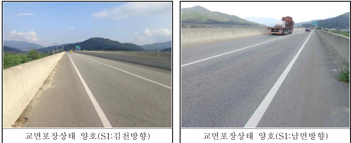
【그림 3.4】 교면포장 손상 현황
