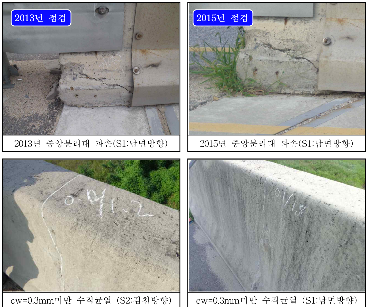
【그림 3.7】 방호벽/중앙분리대 손상 현황
