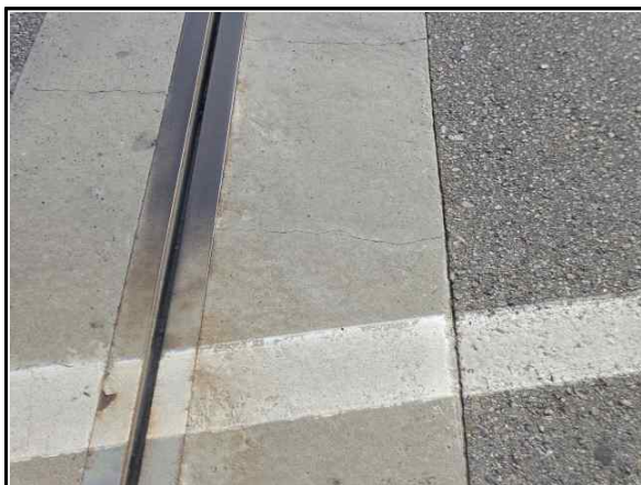
cw=0.3\text{mm} 이상 후타재 균열(Exp.1:김천방향)
