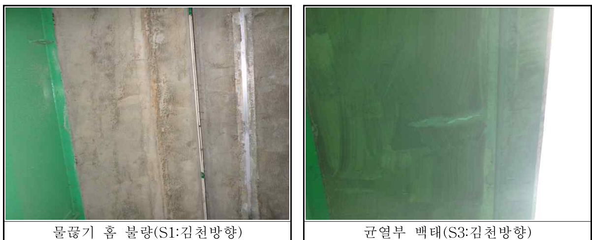
【그림 3.10】 바닥판하면 손상 현황
